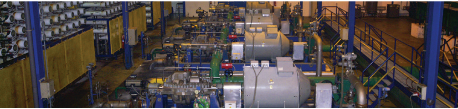
Interior de una estación de desalinización de Lanzarote.
